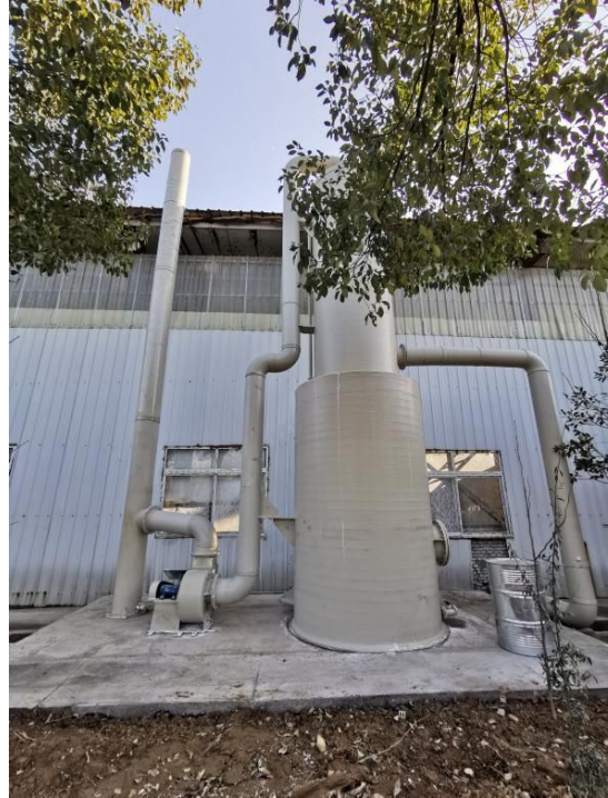
氯气泄漏处理系统
