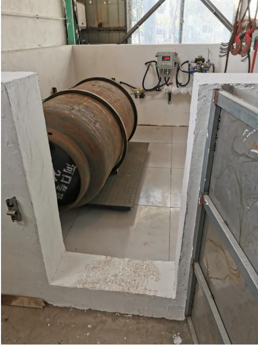
氯气操作间泄露联锁系统
