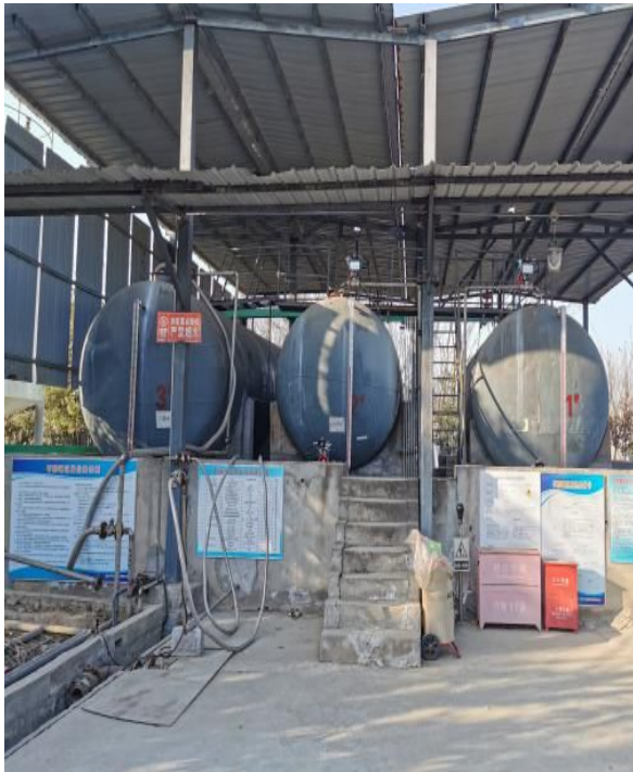
甲醇罐区事故围堰
